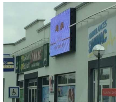
Exemple d'enseigne numérique installée au mur.
